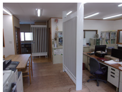
▶事務所内のラジエター
