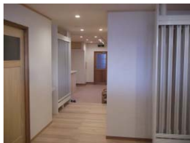
光冷暖を2基設置
